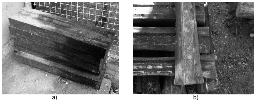
Slika 1. Izgled novih (a) i oštećenih (b) udarnih greda
