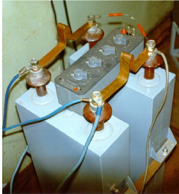
Slika 3. Izgled kondenzatorske baterije
